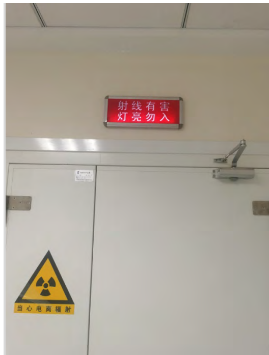
常闭门外设置的放射性标志、中文警示说明和“射 线有害 灯亮勿入”警示灯
